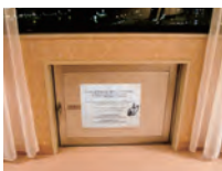
客室内非常口
